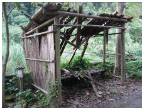
休憩涼亭、座椅嚴重損壞
