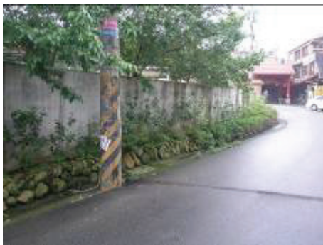
福同宮廟前生硬混凝土擋土牆
