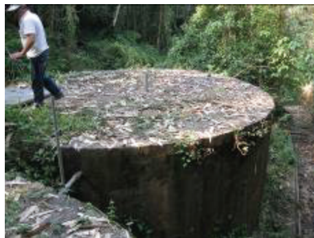
茅埔坑溪上游野溪集水槽
