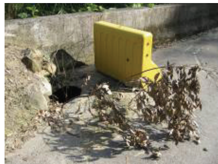
因茅埔坑溪護岸損壞造成多處路基下陷路面破洞
