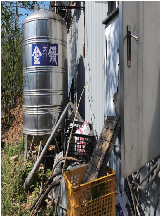
▲圖 5. 地下井水貯放於 10 公噸白鐵水塔並以加壓馬達灌溉。
