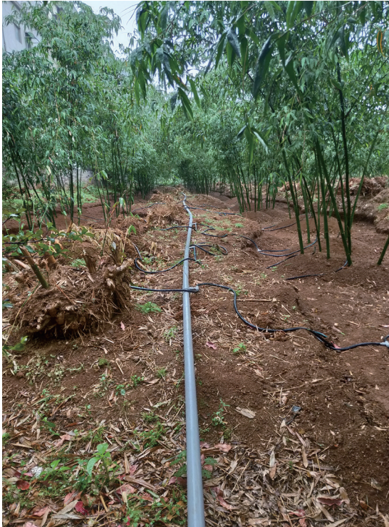
▲圖 2. 主管路採 PVC 硬管 (灰色)，分支為橡膠高壓水管 (黑色)。
