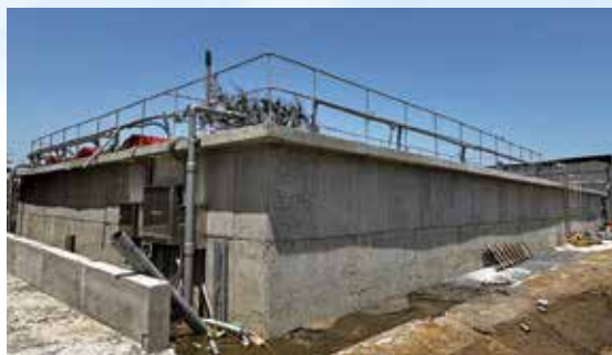
▲圖三、新建廢水設備外觀。
