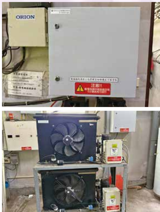
▲圖 2. 北區分所安裝之節電設備。
