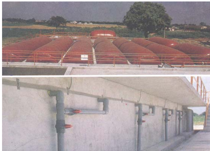
圖 4. 厭氣發酵槽及污泥抽取與迴流攪拌
