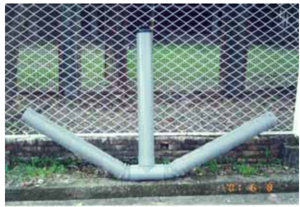
圖 2. 塑膠滲漏水之收集管。
