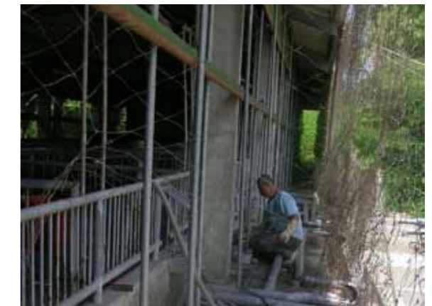
以管線收集廢水，取代舍外糞尿溝
