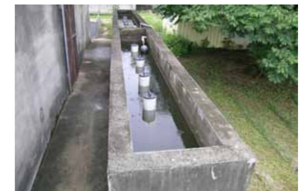
蓄水式沖水設備
