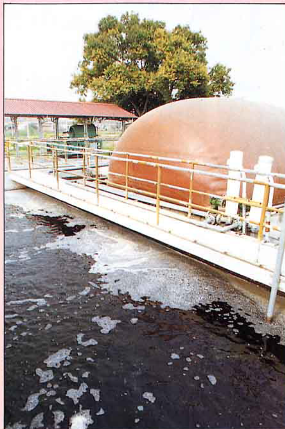
廢水處理設備
