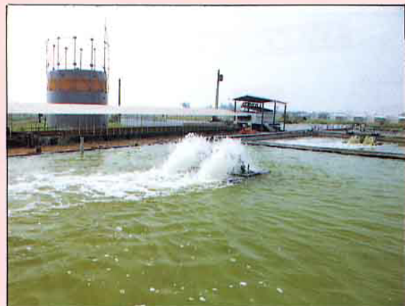
廢水處理設備
