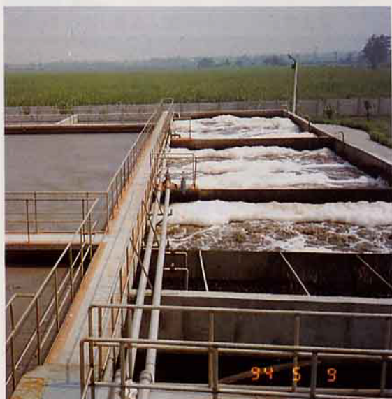
台糖溪湖糖廠萬興畜殖場廢水處理設備
