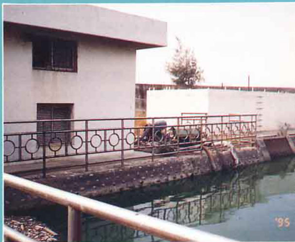
西南海岸地盤下陷地區，須設抽水排水設施，才能排除地面積水
