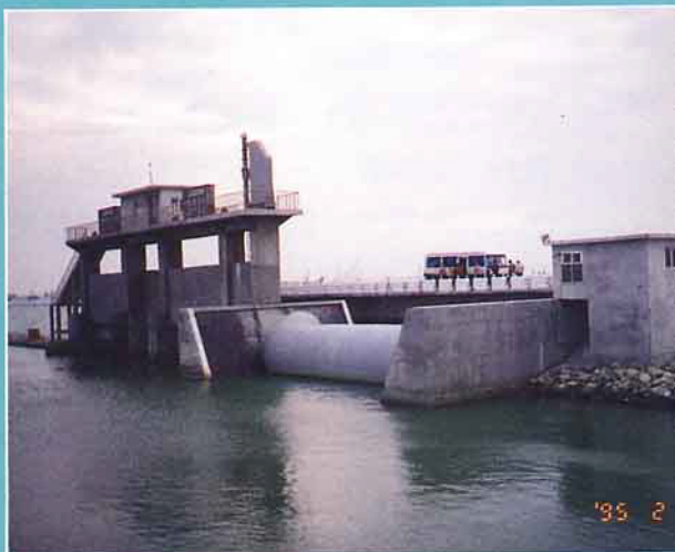
大排水路出口，為防止海水倒灌，設置自動防潮設施
