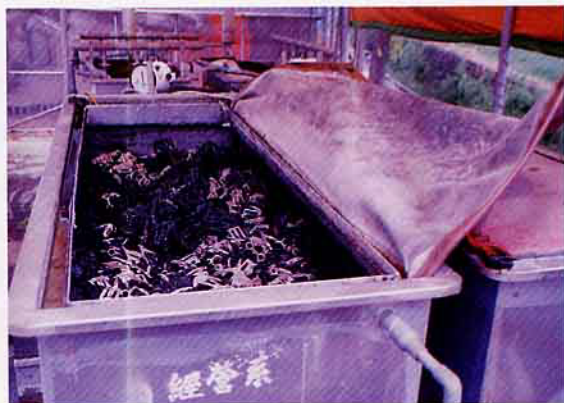
圖 1. 懸浮固定厭氣槽內之懸浮濾料堆置情形
