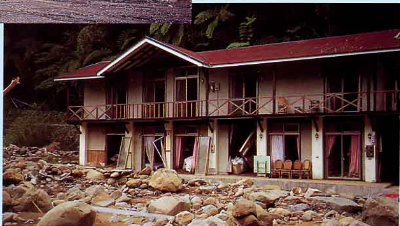
佔用河川地遭致土石流危害
