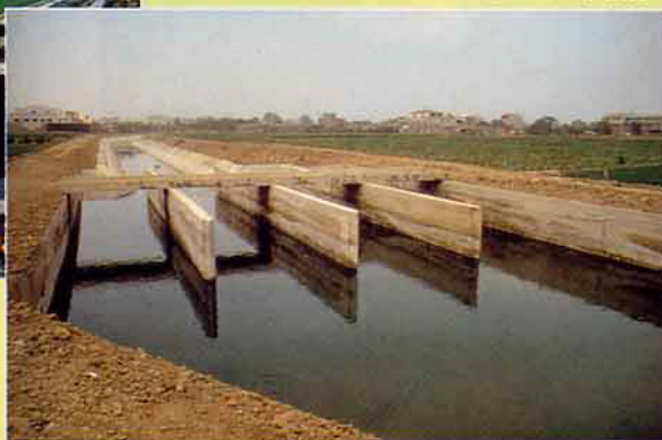
麻豆支線量水設備。
