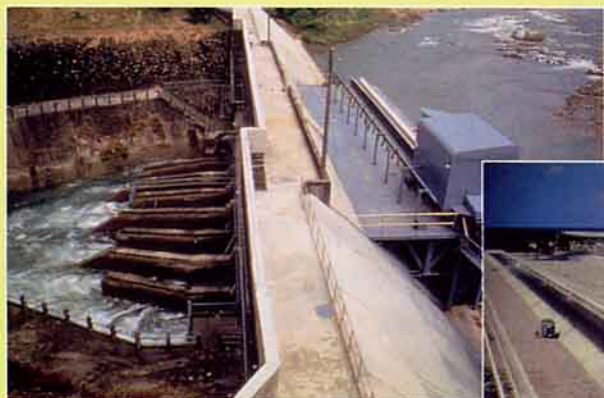
烏山頭自動除塵設備。
