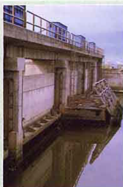
油壓鋼索式水門
