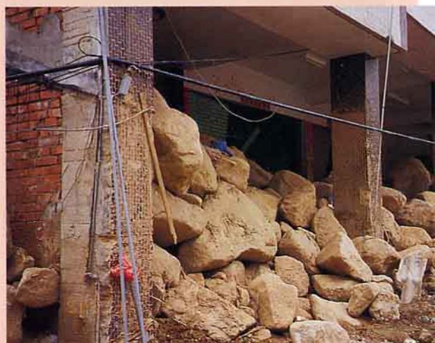
土石流衝入屋內
