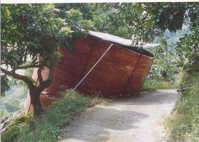
山坡上農業灌溉蓄水池幾乎全毀（陳清文提供）
