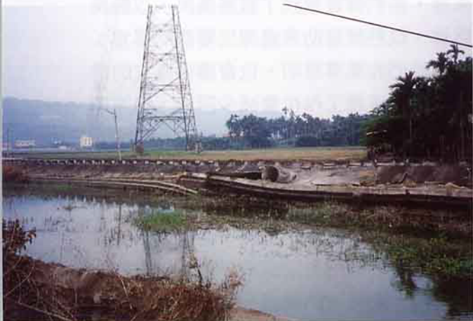
大排水溝震裂了；遇上大雨，下游的居民就遭殃了
