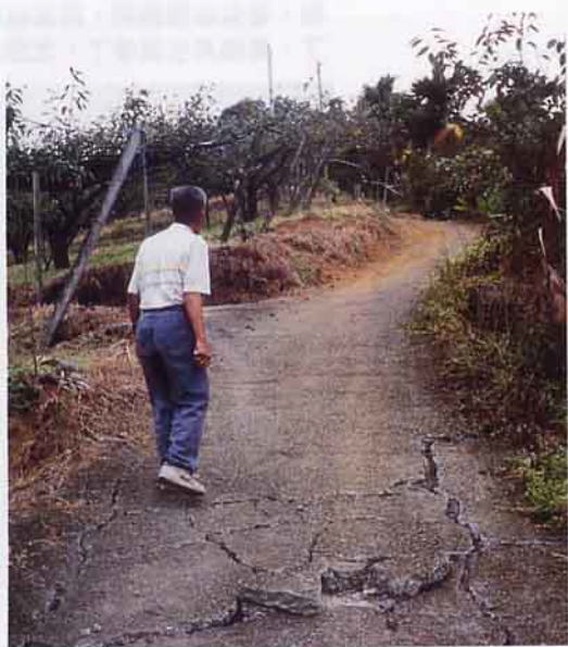
產業道路被震得龜裂難行
