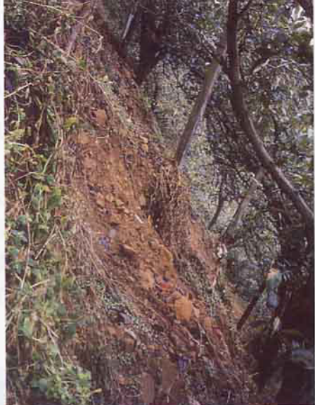
坡地果園崩塌情形
