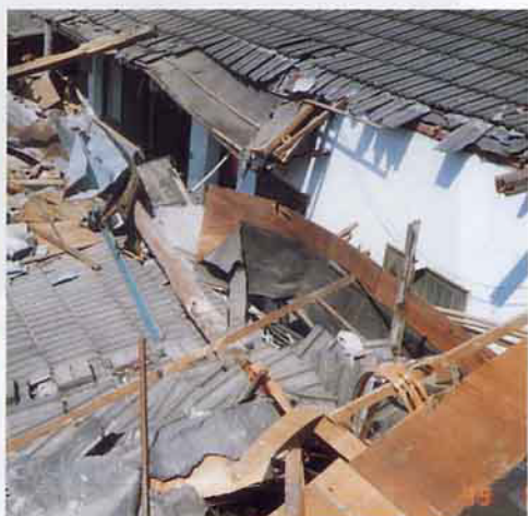
張德生小組長之三合院祖厝受地震震倒情形（張勝煌 攝）
