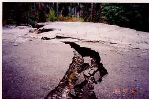
鹿谷鄉農會附近土石崩坍，地表龜裂
