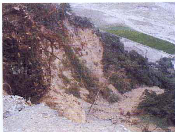
照片4 崩塌產生的崩落土石蓄積於河谷，待大雨降臨造成流量增加時，容易成為土石流的料源（台中縣東勢鎮吊神山區）
