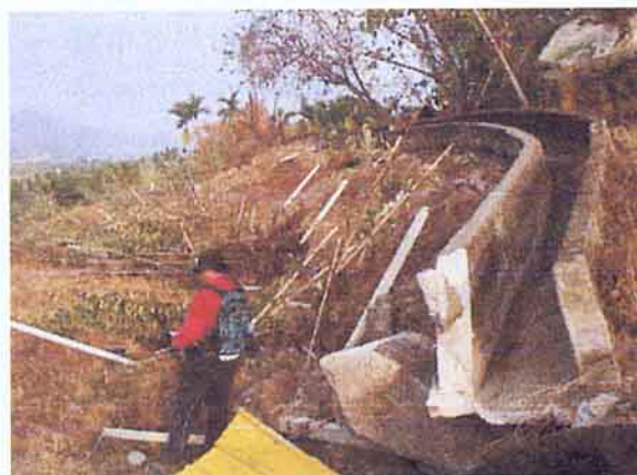
照片5 斷層造成的地面錯移造成排水溝斷裂，也嚴重威脅到排水的正常功能（台中縣東勢鎮泰興里）
