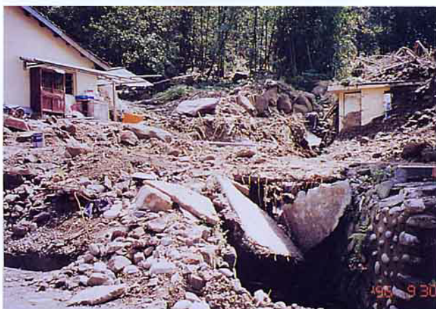
民宅後方為陡坡地，應防崩塌、土石流
