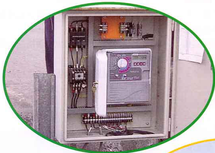
管路自動化灌溉分區灌溉控制箱
