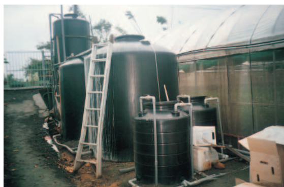
肥液儲放設施
