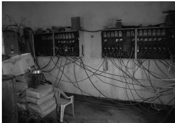
應妥善設置供電中心，維持水電設施的安全及便利
