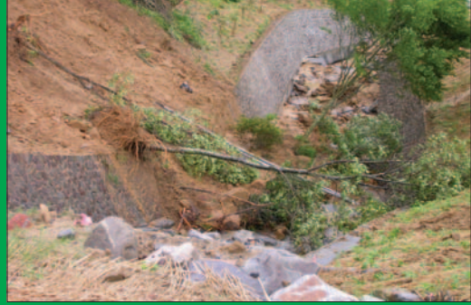
B. 沒有正確依地質條件整修邊坡
