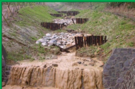
B. 大於 10% 坡降的河床，4 月一場小雨下，獨留泥水與破損的結構。
