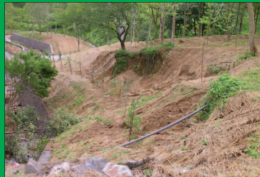
C. 毫無根據的邊坡整治法
