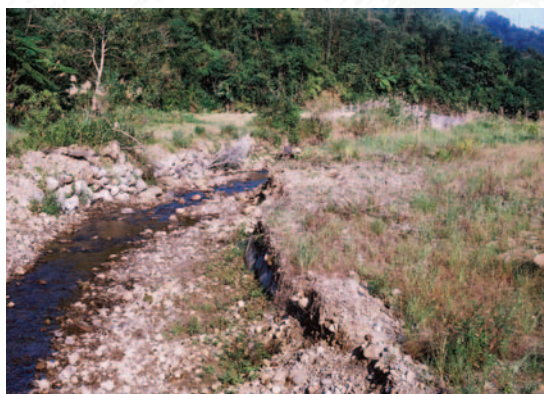
施工前—后番子坑溪左右岸因降雨逕流，產生淘刷情形
