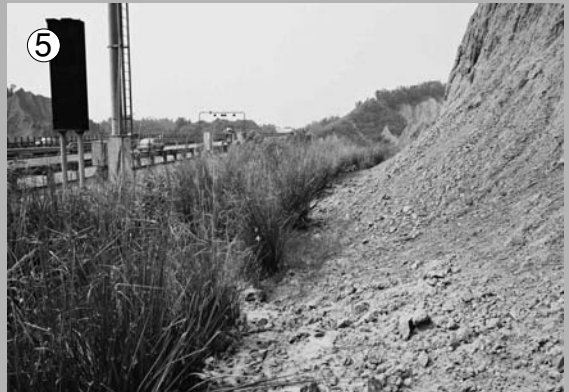
南二高田寮收費站南下隧道口陡峭裸坡坡腳受蝕泥砂沉積區 (2005 年 10 月拍攝)
