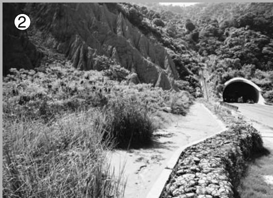
南二高田寮收費站南下隧道口陡峭裸坡坡腳下方用箱籠圍堵泥塊、泥流 (2005 年 6 月拍攝)
