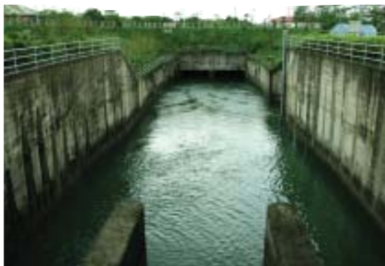
水利設施送水口
