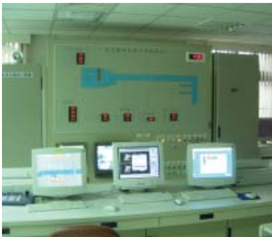
自動化灌溉管理傳訊設施-集集攔河堰北岸渠道監控
