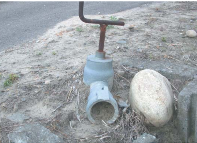
灌溉水路遭破壞
