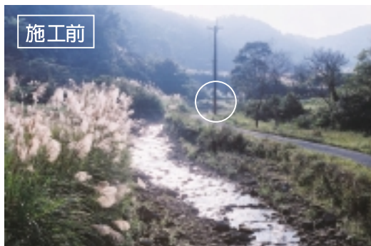
神農橋上游河道左右岸因降雨逕流，產生淘刷情形
