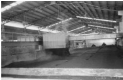
圖7 天車軌道—杓子式發酵槽
