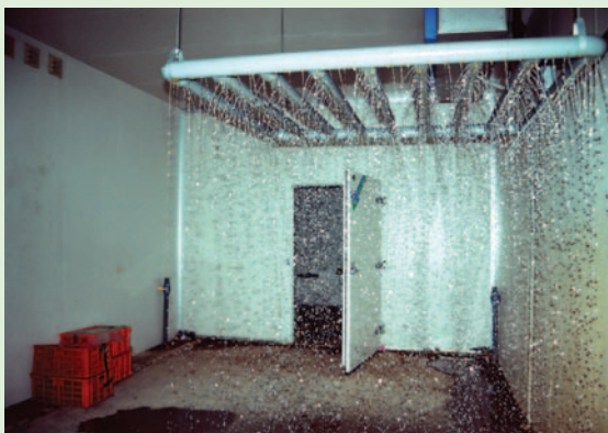
冷水預冷澆灌設備
