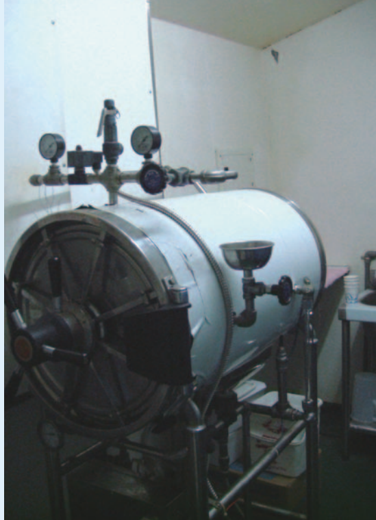
高壓消毒設施
