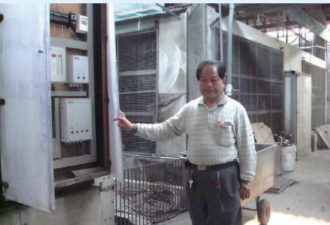
豬舍電腦全自動化控管
