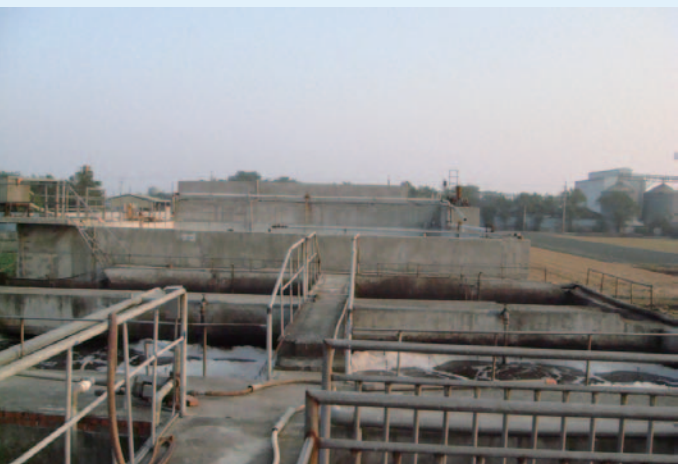
豬場廢水處理場占地遼闊
