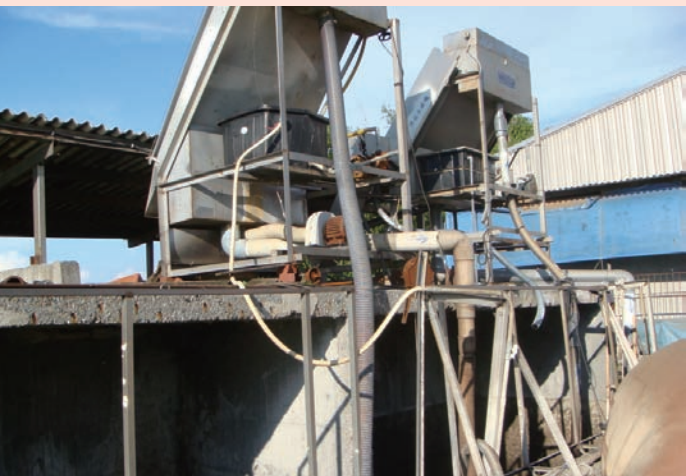
豬排泄物固液分離設備
