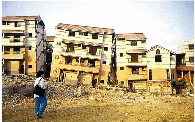
■山坡滑動，建物傾斜，家園如何復建？
