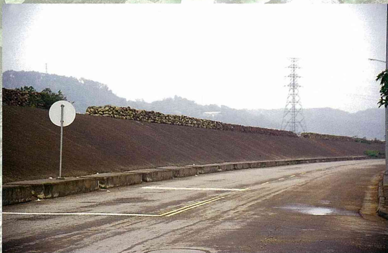
■硬梆梆的堤防，了無生趣。
