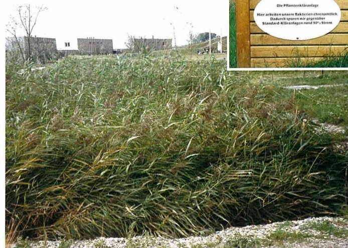
■海曼村以蘆葦淨化池作為農場的污水處理系統。
