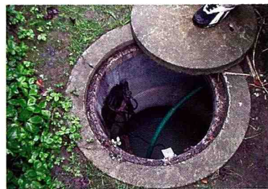
■馬達是蘆葦淨化池唯一的耗能設備。
