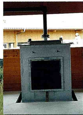
■淤泥收集後之沼氣發電站。
