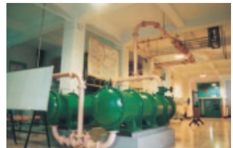
冷卻水抽送設備
