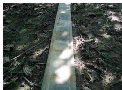
灌溉系統的水管鋪設在地面上
