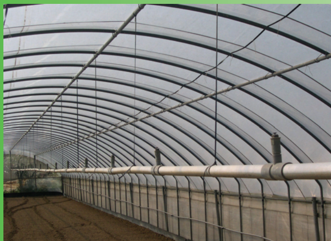
設施內的自動澆灌設備
