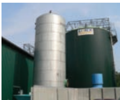
生物氣體貯氣槽
