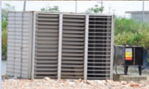
電力、臭氧殺菌、鼓風機等設施
