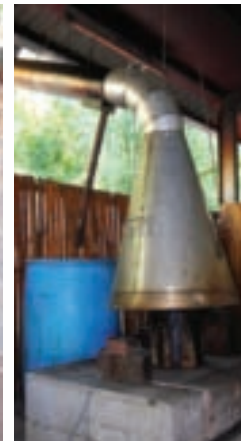
竹醋回收槽設施
