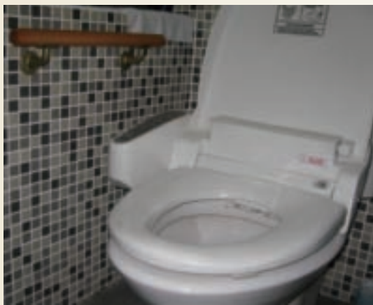
浴廁的馬桶旁邊有扶手
