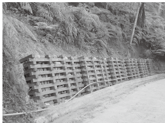
蓮華池新山林道之木框格籠壩擋土牆：保護對象邊坡較低，無須高強度之RC擋土牆或鋼筋混凝土格籠壩。使用防腐木材格框內填卵石，既可保護邊坡亦兼具景觀、環保、生態的多重效果(黃瓊瑜攝)
