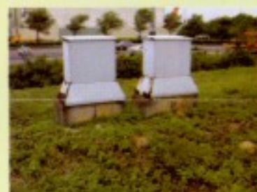
圖 9. 入侵紅火蟻危害電器箱
