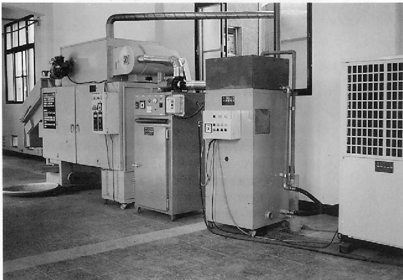
▲圖2. 除濕輪乾燥機組：可密閉連續式乾燥機(左一)、除濕輪及冷凝管機組(右二)、散熱器及壓縮機組(右一)
