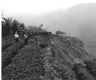
●八掌溪上游河道沖蝕造成路基流失，竹崎光華茶園崩落
