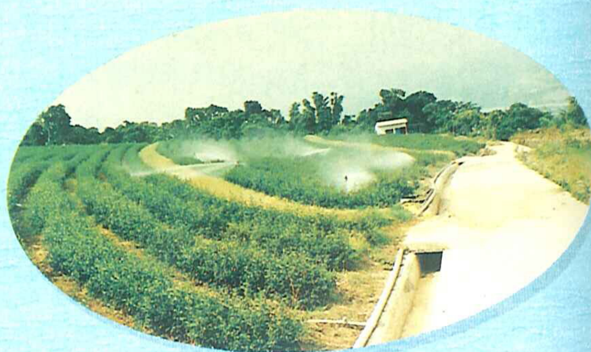
多目標自動噴藥設施
